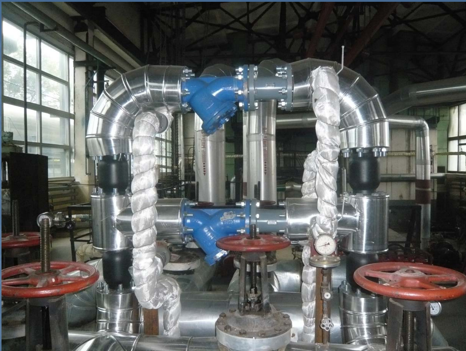
АППАРАТЫ КЭМ-125-40 НА МАЗУТНОЙ СТАНЦИИ №2 НЕВИННОМЫССКОЙ ГРЭС.
