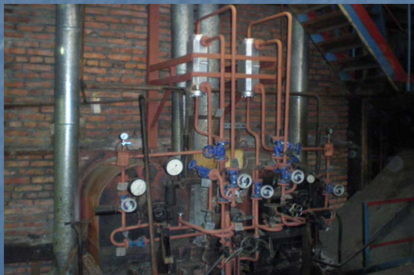
ПРЕДФОРСУНОЧНЫЕ ДОГРЕВАТЕЛИ МАЗУТА ДКМ НА КОТЛЕ ГМ-50 НА ПРЕДПРИЯТИИ ОАО «АПАТИТ».
